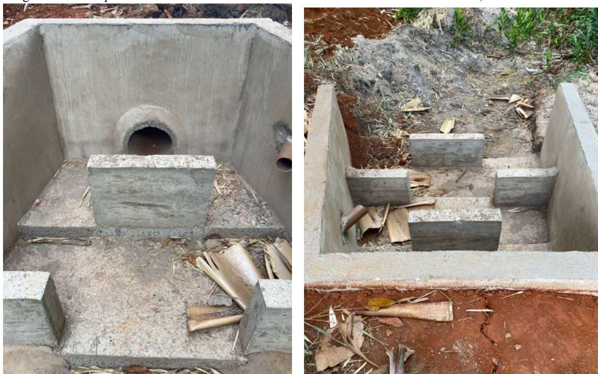
Imagem 127- Dissipador instalado no Condomínio Mata da Nascente em Monte Carmelo, MG.
