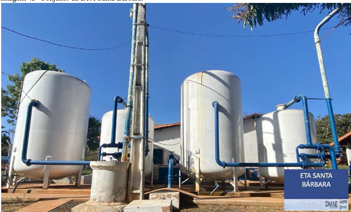
Imagem 43- Conjunto da ETA Santa Bárbara.
