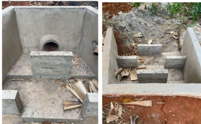
Imagem 127- Dissipador instalado no Condomínio Mata da Nascente em Monte Carmelo, MG.
