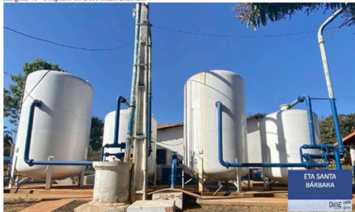
Imagem 43- Conjunto da ETA Santa Bárbara.
