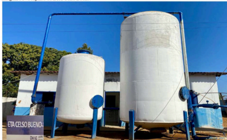
Imagem 51- Conjunto da ETA Celso Bueno.
